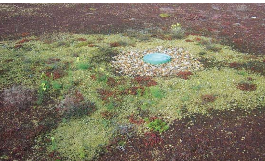
Foto 3 Typisches Schadbild nach einem Starkregen: Um den Ablauf hat sich ein See gebildet, dessen Umrisse noch durch die leichten Bestandteile (hier der helle Bims) zu erkennen sind. Entwässerungsprofile bzw. leistungsfähige Dränelemente hätten den Rückstau um den Kontrollschacht vermieden.
