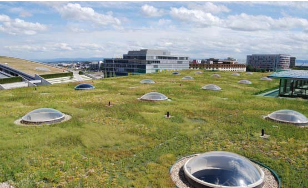
Foto 1 Extensivbegrünung mit langen Fließlängen: Hier wird eine mehrschichtige Bauweise empfohlen, da Einschichtsubstrate die anfallenden Wassermassen nicht schnell genug ableiten können.
