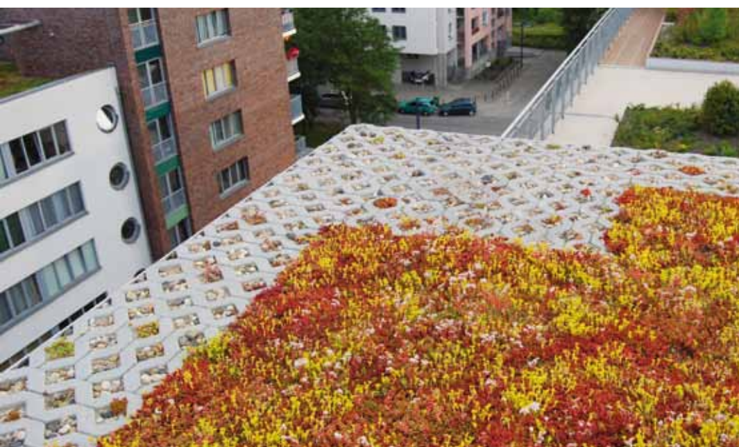
Windexponierte Bereiche müssen gegen Verwehungen gesichert werden, bei- spielsweise durch Rasengittersteine und Vegetationsmatten
